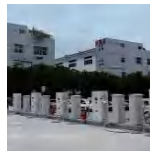
深圳新桥充电站
